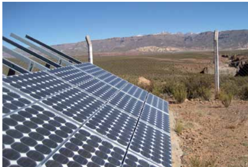
Solaranlage in Peru, Foto: Deutsche Welle/Michael Altenhenne/Flickr.com
